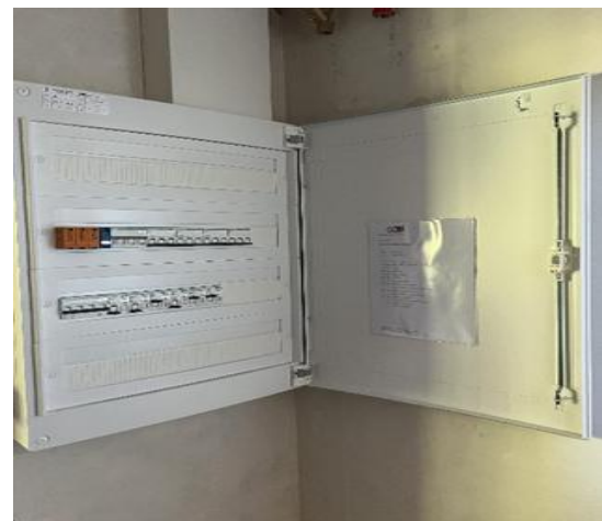
Der neue Elektro-Sicherheitskasten ist angeschlossen.
