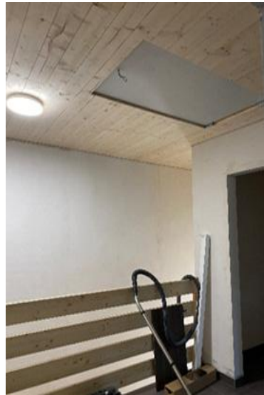
Versenkbare Estrichtreppe im OG zum Notschlafraum im Estrich
