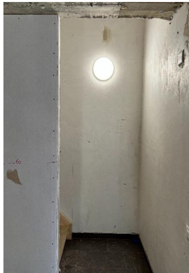
Beleuchtung Korridor und Treppenaufgang im EG
