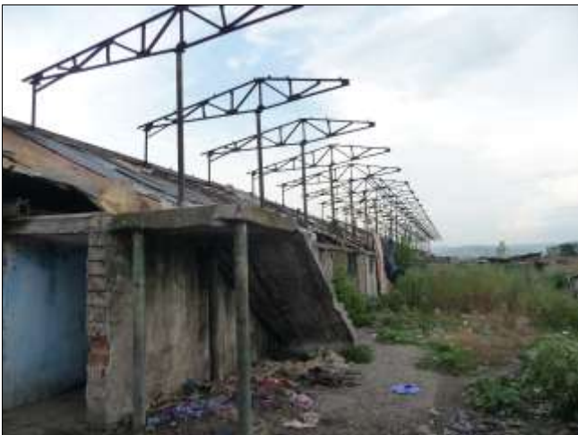
Illegale Siedlung für ca. zehn Familien in den ehemaligen Garderoben eines verfallenen Fussballstadions.
