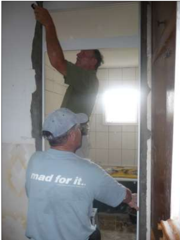
Ernst und Walter beim Anpassen und Einbauen der neuen Türrahmen und Türen.
