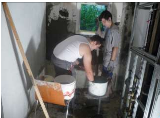
Pascal und Thomas bessern die Mauern aus und verputzen sie für eine gerade Auflagefläche der Keramikplatten.
