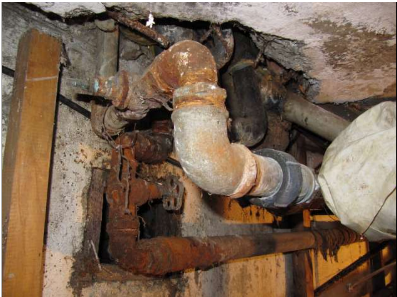
Katastrophal verrostete und undichte Leitungen im Keller und in den Badezimmern.
