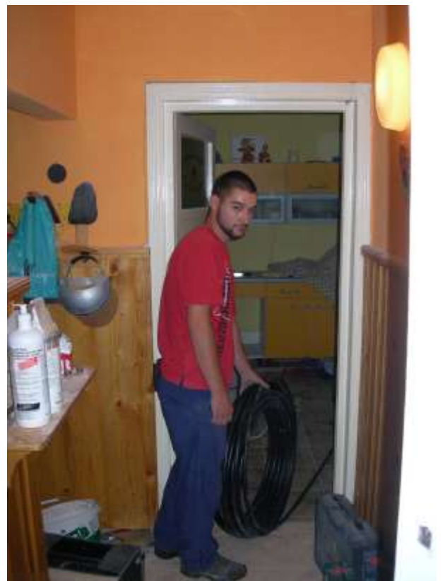
Csaba, der rumänische Dolmetscher legt auch Hand an bei der Montage der Mepla-Wasserleitungsrohren.
