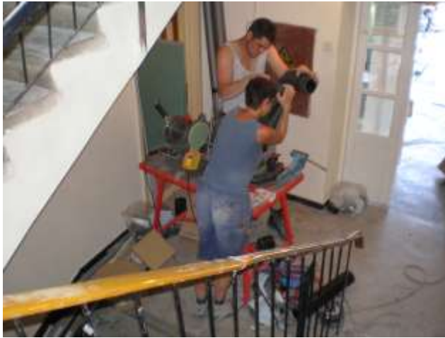
Hier entstehen komplizierte Ablaufkombinationen dank Silvia und Lukas für die Umgehungsleitungen im Keller.
